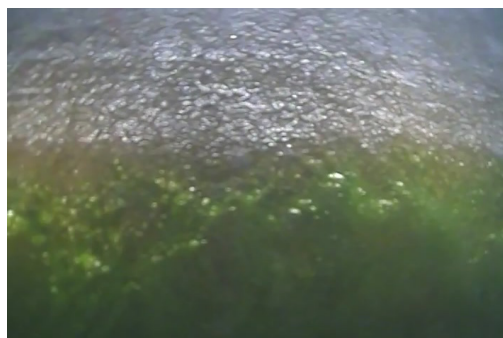
藻に覆われたコンクリート壁面の画像
